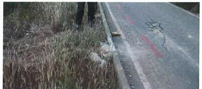
Figura 4.2.1d: Daños en la carretera de bajada del castillo causados por el rebote del bloque desprendido del espolón (foto 1.b).
