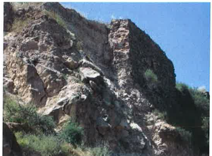
Figura 4.2.1f: Vista de detalle de la caída de parte del muro de contención antiguo. Se observa el relleno de intradós que permanece metaestable. Este tipo de inestabilidad también se ha producido en la falda sur del cerro del castillo (ver foto 2.1).
