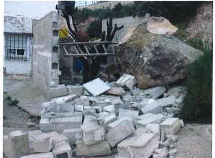
Figura 4.2.1c: Impacto en el muro de bloques de hormigón del patio de una vivienda producido por la caída de una roca del espolón.
