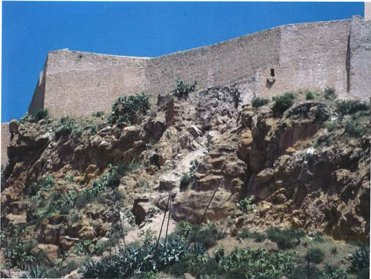
Figura 4.3.1: Desmoronamiento de un antiguo murete de contención adosado a la muralla exterior del castillo de Lorca en su falda N. Esta inestabilidad alertó a los habitantes de las viviendas situadas más abajo, preguntándonos in situ si era seguro volver a sus viviendas.
