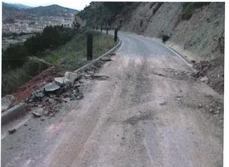
Figura 4.2.4b: Daños en el pavimento de la carretera de subida del castillo por la caída y rebote del bloque rocoso de la foto 1.4a.
