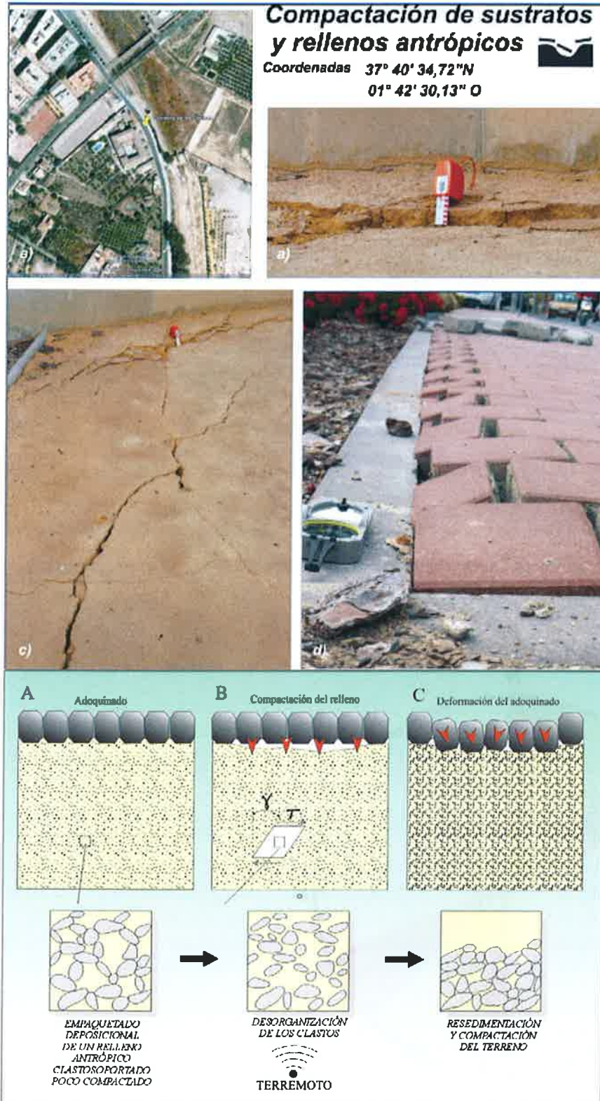
Figura 5.9 Compactación de sustratos y rellenos antrópicos asociados al Convento de las Clarisas. Nuevo EAE descrito.
