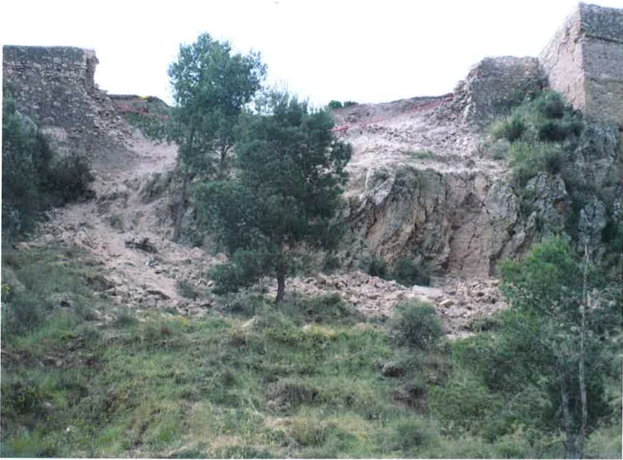
Figura 4.2.5: Colapso de la muralla exterior del castillo de Lorca (falda N del cerro del Castillo).
