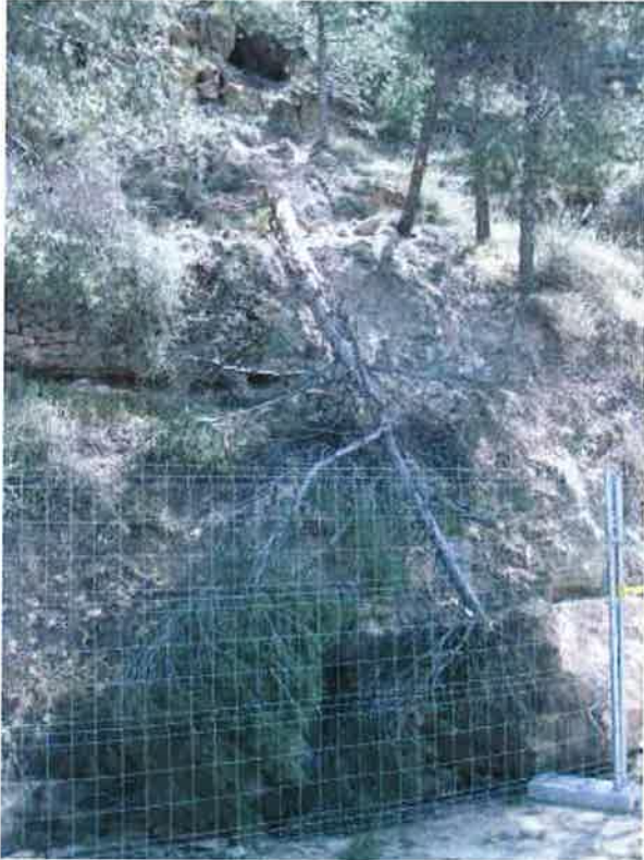
Figura 4.2.2: Pequeño desprendimiento con arrastre de un pino. Talud S de la carretera de subida al castillo.
