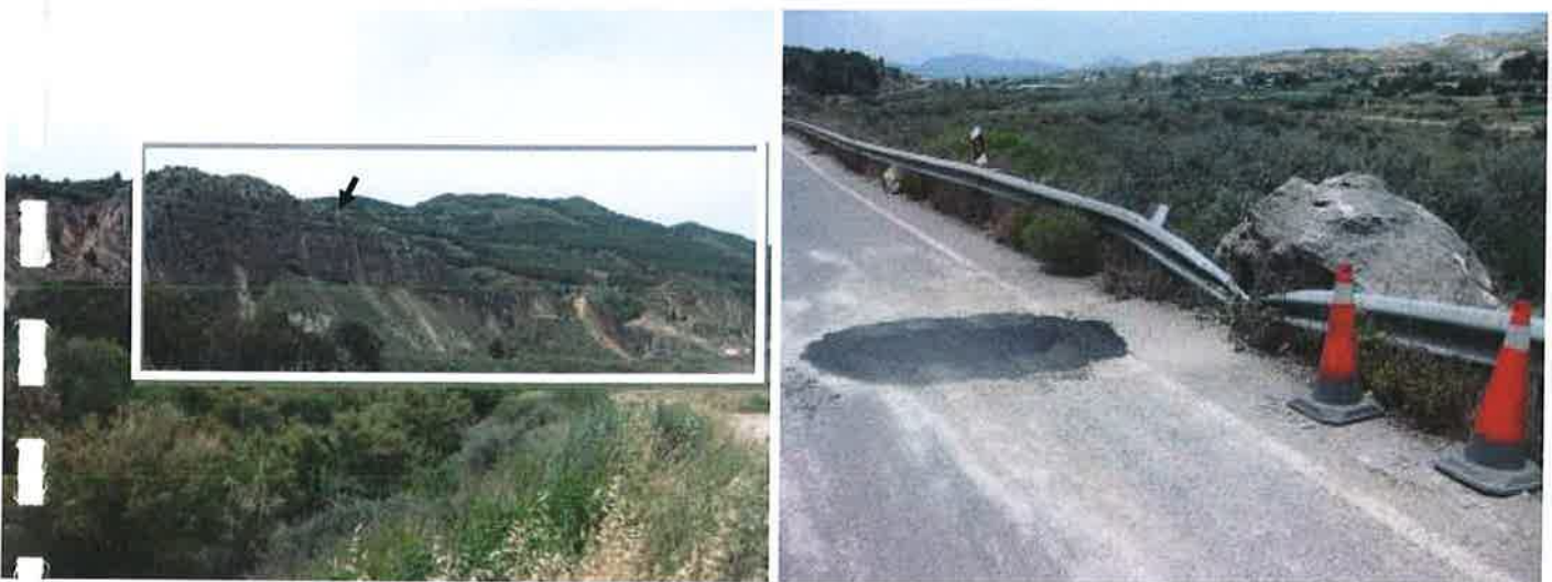
Figura 4.4.1b: Continuación de la carretera del pantano de Puentes hacia el oeste. A lo largo de la misma se han identificado numerosas inestabilidades, aunque de pequeña entidad. Destaca la caída de bloques con origen en la resta rocosa controlada por la falla de Las Viñas (señalado con una flecha). En la foto de la derecha se observa en detalle de los daños producidos por la caída de uno de estos bloques.
