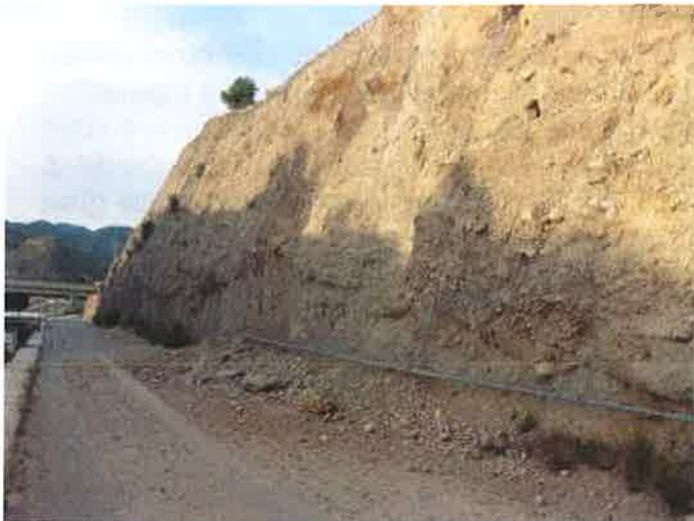
Figura 4.9: Desprendimientos superficiales atribuidos a los terremotos de mayo en un talud de la carretera de servicio del canal Tajo-Segura.
