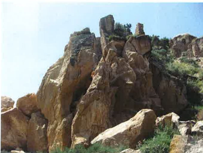
Figura 4.2.1e: Vista de proximidad del desprendimiento del espolón (hacia el sur) y de las condiciones generales del macizo rocoso en este punto. En el extremo derecha se observa parte de la caída de un muro (ver foto 1.1f).
